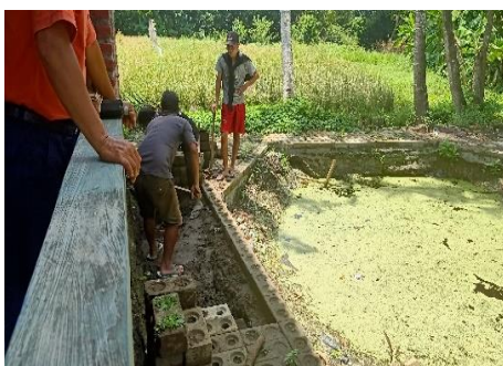
Amblesan di sisi gedung PAUD
