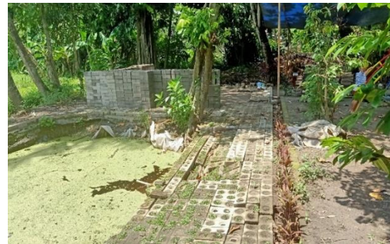
Sesudah terjadi ambles
